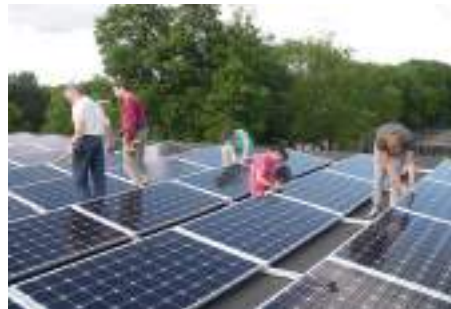
Deelnemers van Zon op KWC plaatsen samen zonnepanelen op het dak van het Koningin Wilhelmina College (juni 2014)
